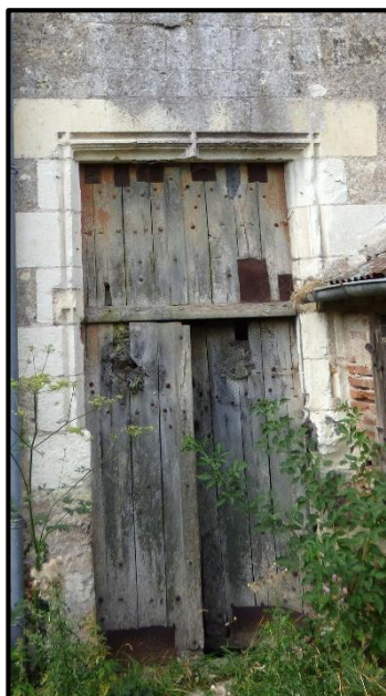
Figure 187. Fenêtre façade Nord, dont la croisée de pierre a disparu et transformée en porte donnant accès à un cellier en contre-bas.
