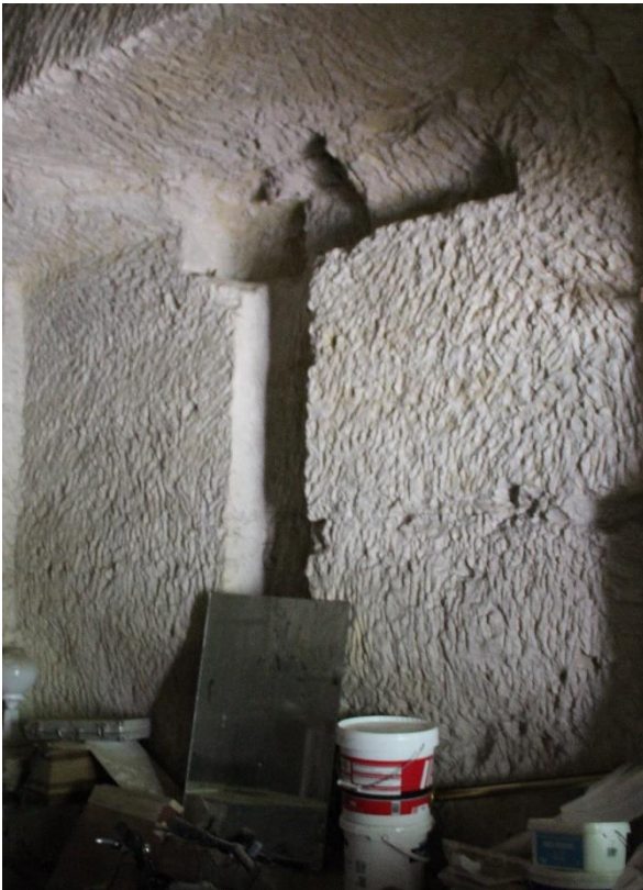
Figure 88. Dans la seconde cave, la paroi porte la trace de l'ancienne présence d'un pressoir de taille importante
