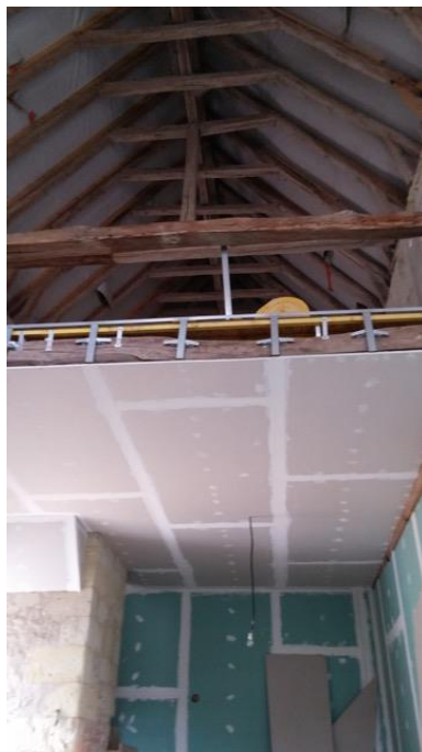
Figure 123. L'intérieur en cours de travaux; la majorité des entrants a été coupée
