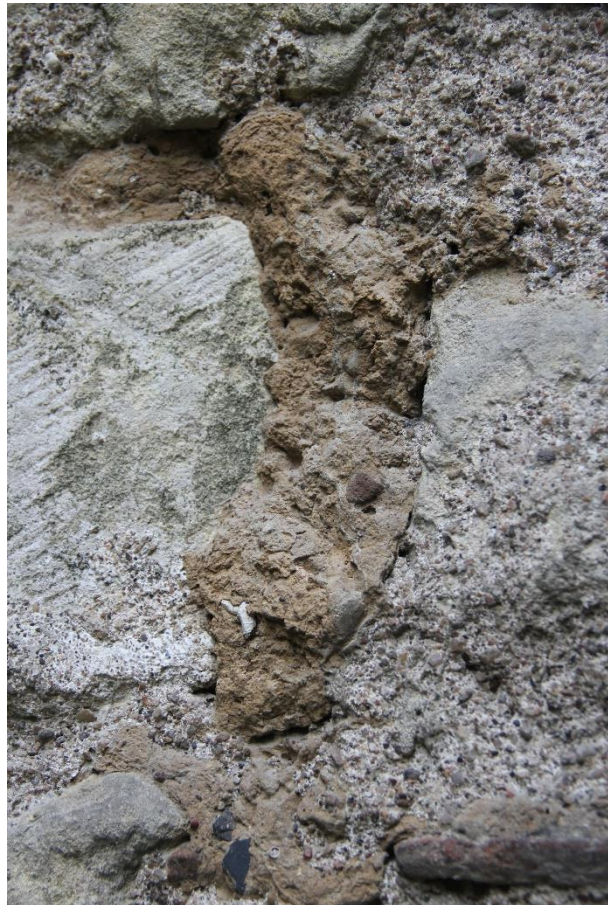
Figure 31. On peut constater la présence de joints en argile, certaines fractions ont été recouvertes de ciment : réalisation probablement tardive avec une motivation de protection
