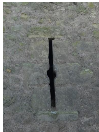
Figure 110. Présence d'étranges meurtrières
